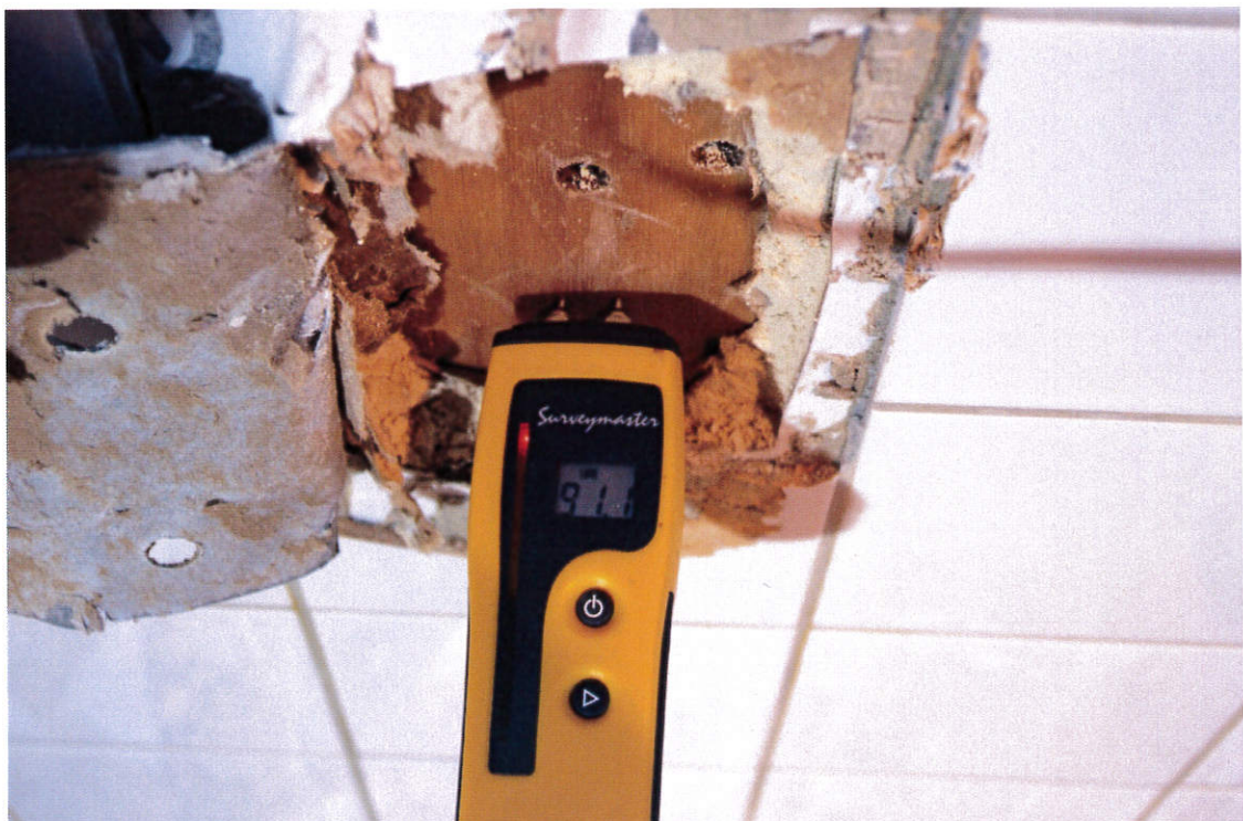
Bild 14. Fuktindikering i plywood vid handfatsinfästning med Vipp-plugg.
