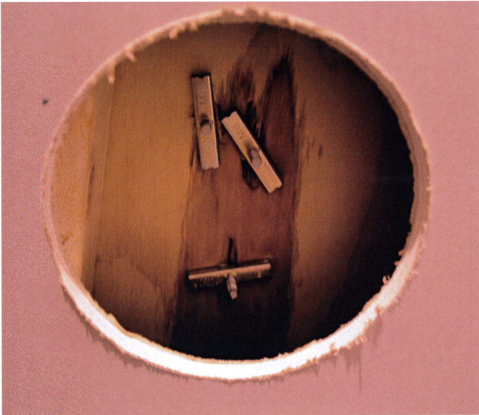
Bild 13. Läckage vid handfatsinfästning med Vipp-plugg, sett från baksida vägg.
