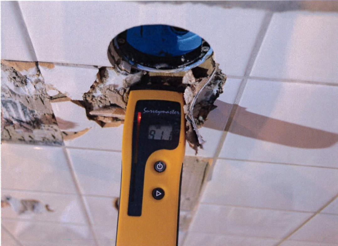
Bild 15. Fuktindikering i plywood under anslutningsdosa.
