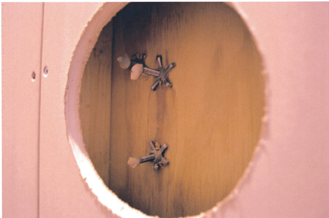
Bild 35. Baksida av handfatsinfästning med metal-expander. Läckage vid första vattenbegjutningen.
