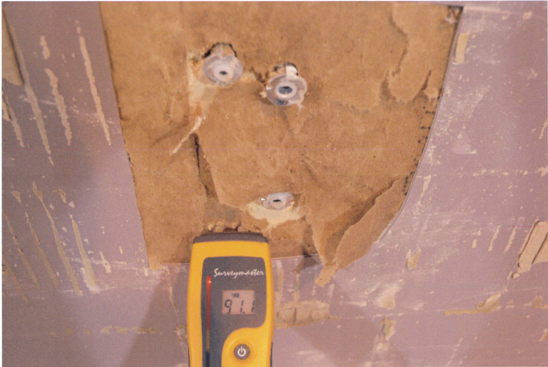
Bild 36. Kraftigt förhöjd fukt vid handfatsinfästning med metal-expander, efter demontering av tätskikt.
