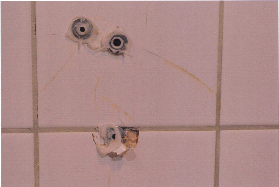
Bild 34. Handfatsinfästning med metal-expander efter demontering, sprickor i kakel.
