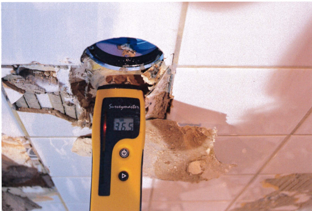
Bild 16. Fuktindikering i plywood under vägguttag.
