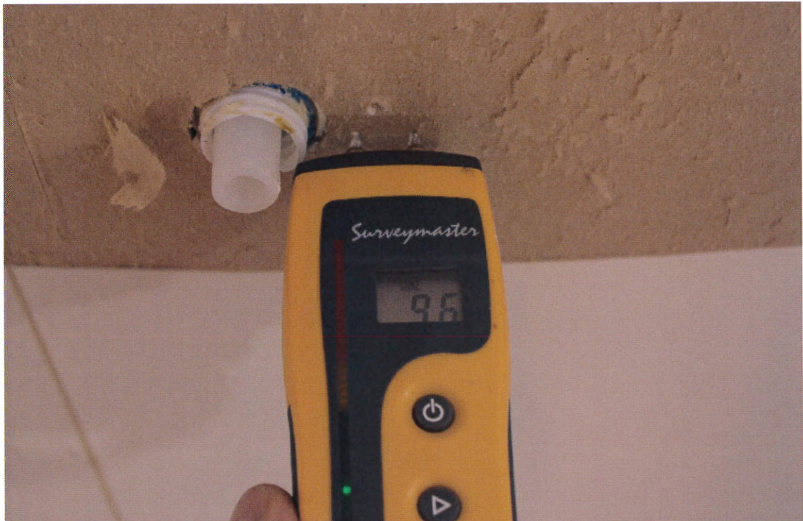
Bild 27. Kontroll av fukt vid infästning för duschblandare infäst endast i plywood.
